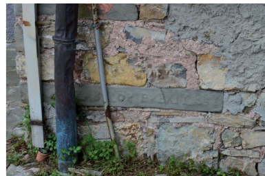
FIG. 10 - Blocco sagomato di arenaria, certamente della chiesa antica, forse parte d'un altare, murato nel luogo più infelice possibile, quasi rasoterra, coperto per la metà dalla grondaia e da due guaine metalliche di cavi elettrici. Impossibile decifrare l'iscrizione.
